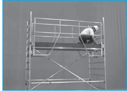
4 - Pose du plancher à trappe, accès au niveau supérieur et pose des plinthes.
