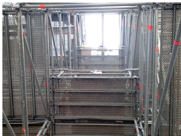
En position horizontale, le plancher peut recevoir la charge apportée par le treuil du monorail
